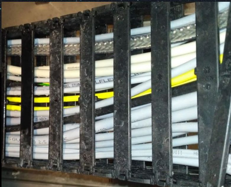
Prowadniki kablowe od szafy sterowniczej
